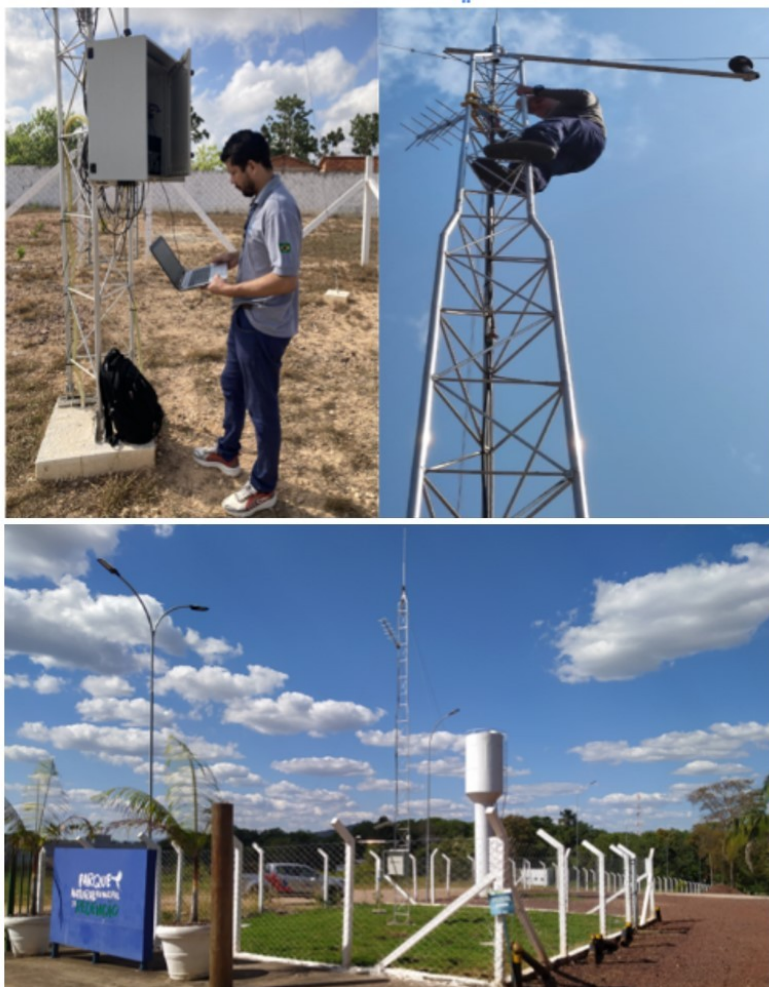
Figura 39 - Instalação de equipamentos para monitoramento hidrometeorológico.
