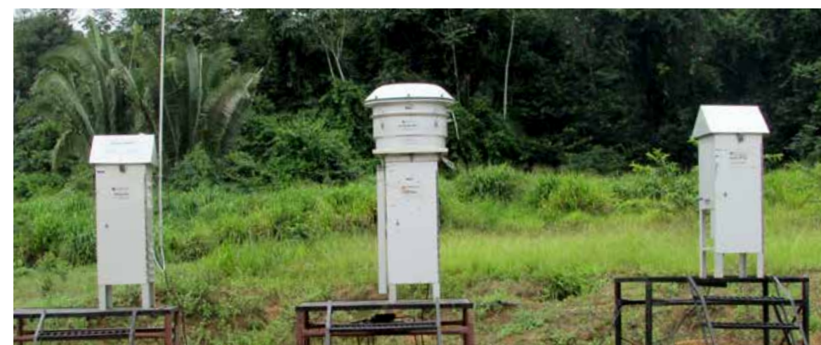
Equipamentos instalados para coleta
