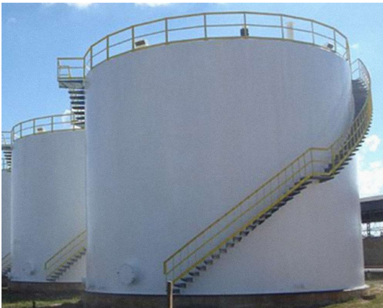
Exemplo de tancagem. Fonte: Planave, 2018.
